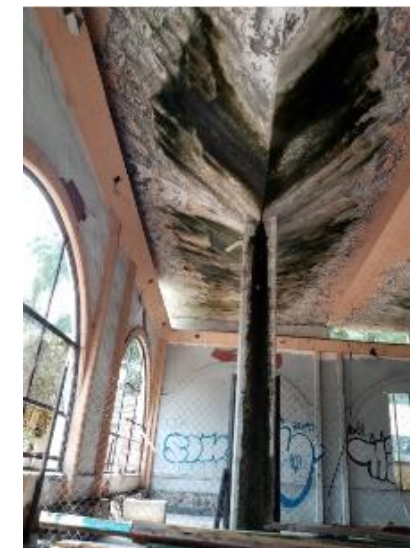
E. Escorrentías que presenta la techumbre
