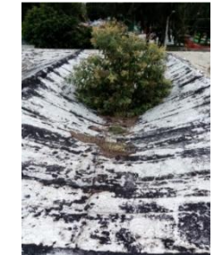
L. Obstrucción de bajadas de agua pluvial
