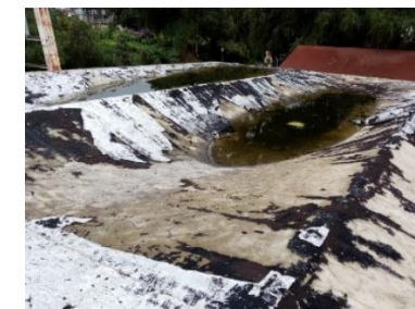
K. Acumulación de agua pluvial en techumbre.
