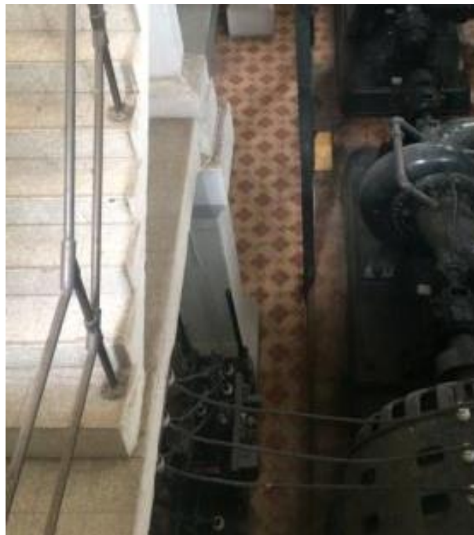
Imagen 58: Piso de sótano y escalera en la Casa de Bombas No. 5. Fuente: Autores, Junio 2020
