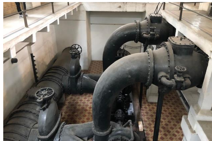
Imagen 5. Rodríguez, K. 2019. Elaboración propia. Maquinaria Casa de Bombas San Luis Tlaxialtemalco
