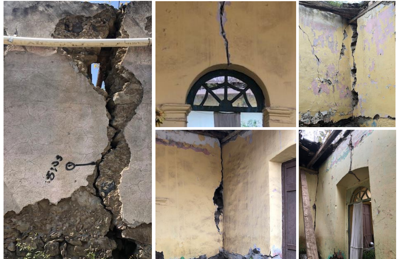
Imagen 115. Collage Fotografías grietas parte interior casa de piedra. Elaboración propia.
