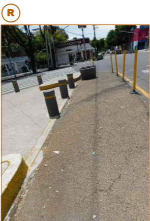
ÁREAS DE CRUCE SEGURO, LAS PIEZAS SE CONSERVAN EN BUEN ESTADO EN ESTE PUNTO
