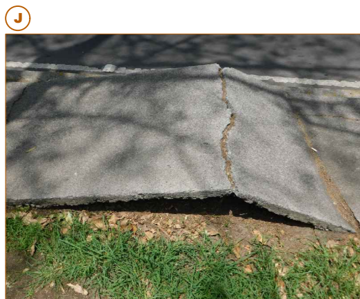
PISOS DE CONCRETO CON DETERIOROS, PRINCIPALMENTE POR DONDE ATRAVIESA LA GENTE
