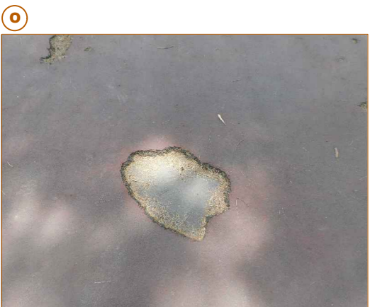
DETALLE DE PISO TIPO TARTÁN CON DETERIORO.
