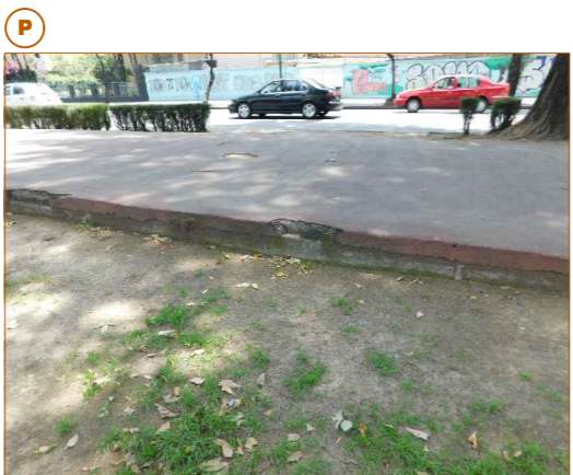
AL NO DELIMITARSE LOS PASOS, LOS CANTOS DEL PISO PRESENTAN DETERIORO
