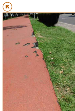
PISO TIPO TARTÁN CON DETERIOROS
