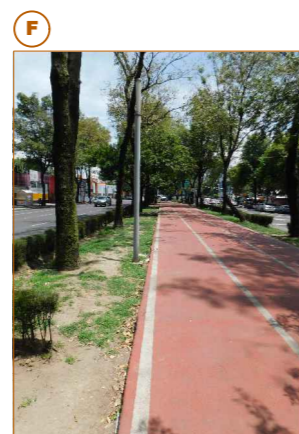
LUMINARIAS, INSUFICIENTES A LO LARGO DE LA PISTA-CAMELLÓN.
