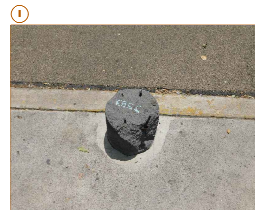
ALGUNOS ELEMENTOS COMO LOS BOLARDOS PRESENTAN DETERIOROS.
