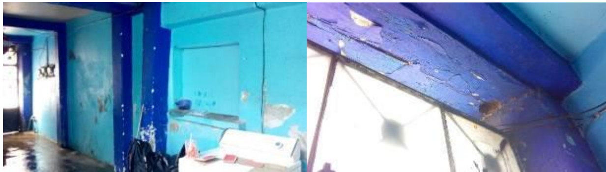
Ilustración 57 Acceso a patio sur, Fuente propia Ilustración 58 Marco existente de puerta de madera. Fuente propia
