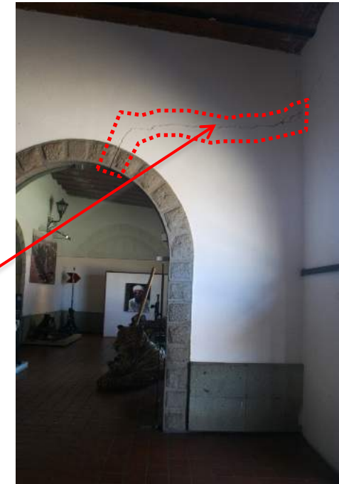
Figura 107. Detalle grieta al interior del edificio de la estación Fuente archivo del autor
