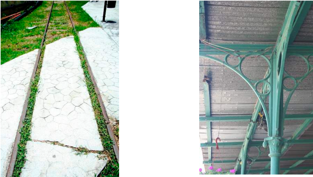
Figura No.135 De lado derecho podemos observar algunos deterioros que se presentan en los pavimentos y sus juntas con los rieles. De lado izquierdo un detalle de la estructura del andén de hierro colado y también las instalaciones eléctricas mal resueltas o improvisadas. Fuente Archivo del autor
