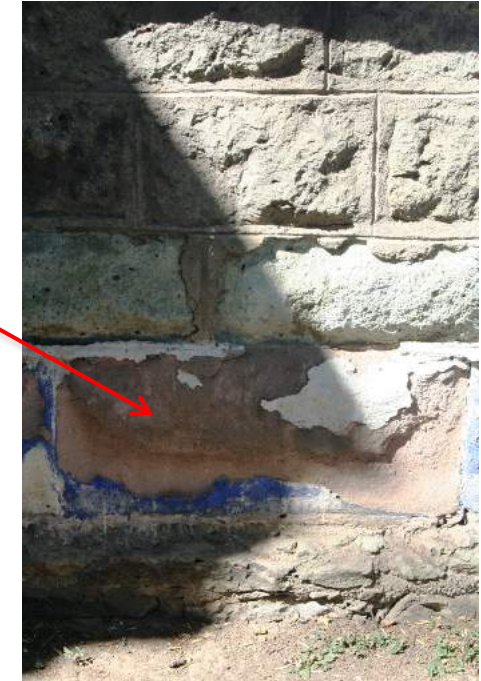
Figura 104. Detalle fachada este del edificio de la estación Fuente archivo del autor
