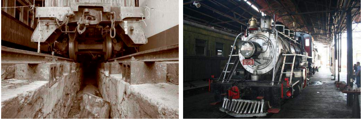
Figura No.136 En una primera vista puede apreciarse uno de los fosos de mantenimiento que no se encuentra en las mejores condiciones, donde los apoyos están expuestos y solo embebidos en dados superficiales de concreto. En el lado izquierdo podemos observar la máquina 279 que persiste en el sitio y que se encuentra situada encima de uno de estos fosos. En la misma toma fotográfica se puede ver el interior de los talleres. Fuente Archivo del autor
