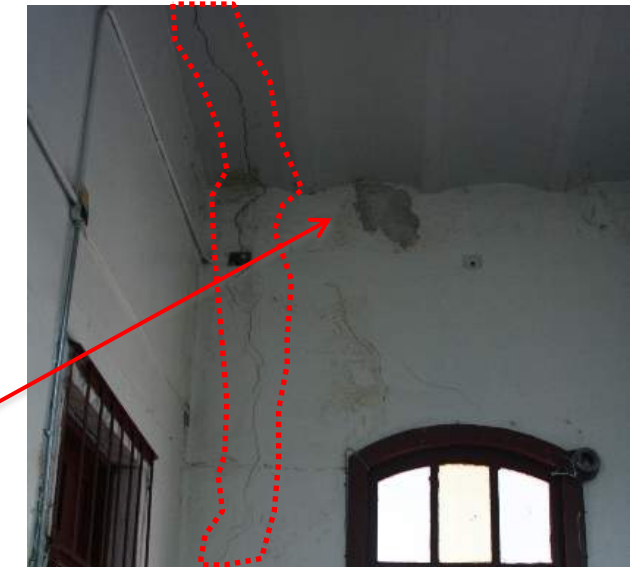
Figura 110. Detalle de eflorescencias por filtraciones de la cubierta al interior del edificio de la estación. Fuente archivo del autor
