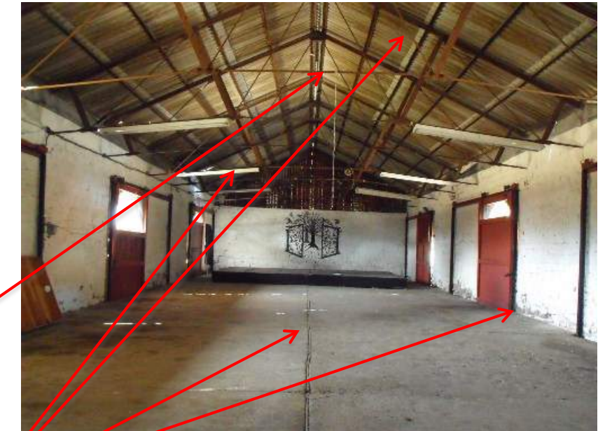
Figura 114. Se puede ver en esta foto el interior del edificio de las bodegas. Foto archivo del autor
