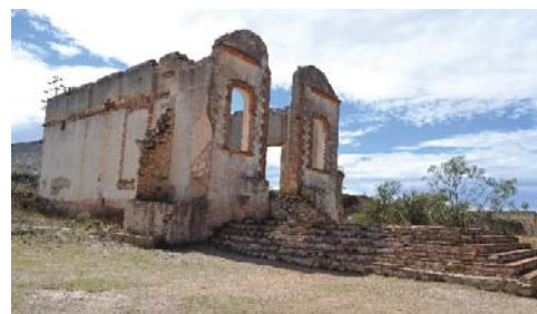
Casa de Máquinas en ex hacienda minera El Triángulo, Mineral de Pozos, Guanajuato. Fuente: elaboración propia
