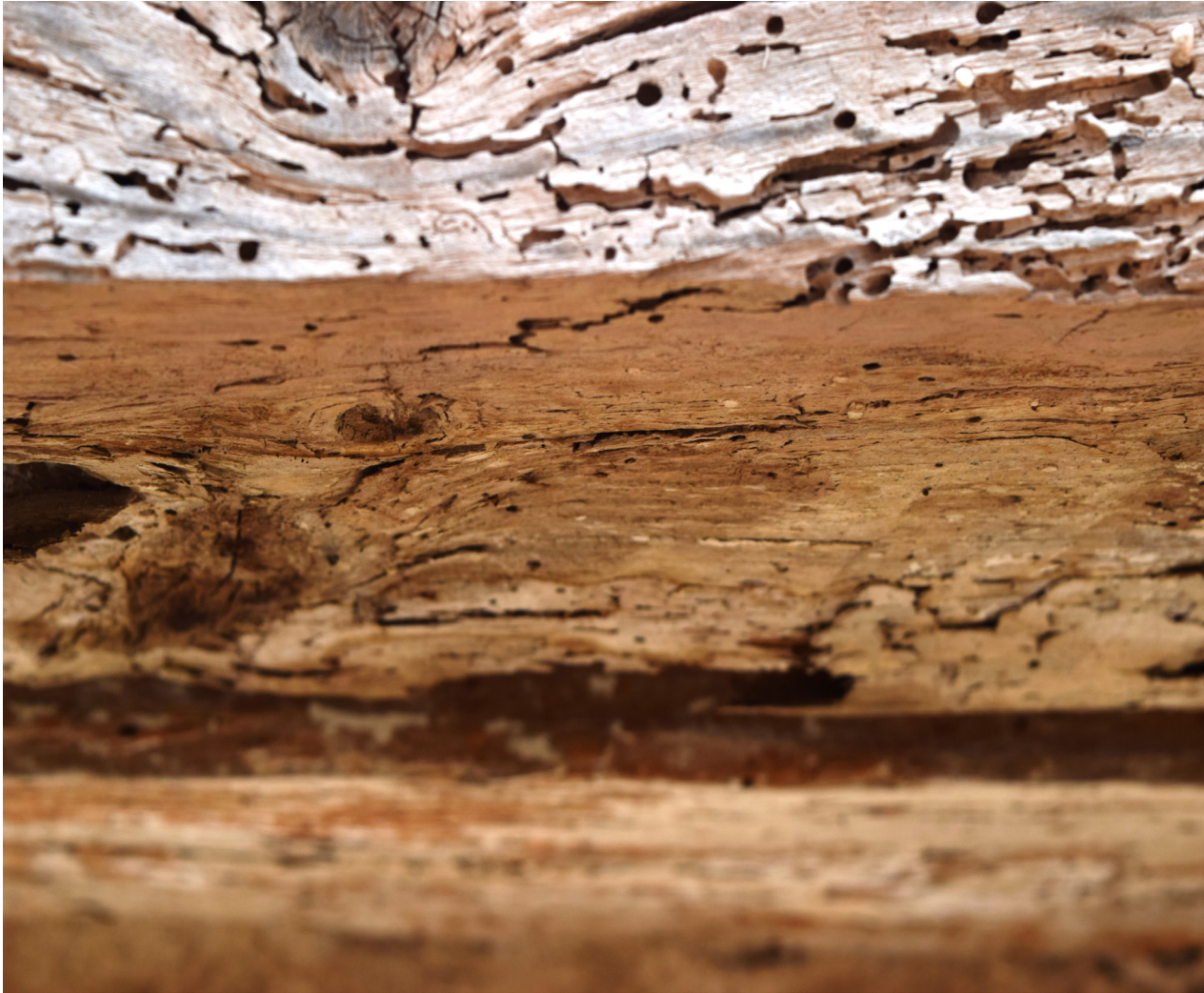
(fotografía 95: Daniel Vargas ) (Mineral de Pozos 2016)daños en la madera existentes.
