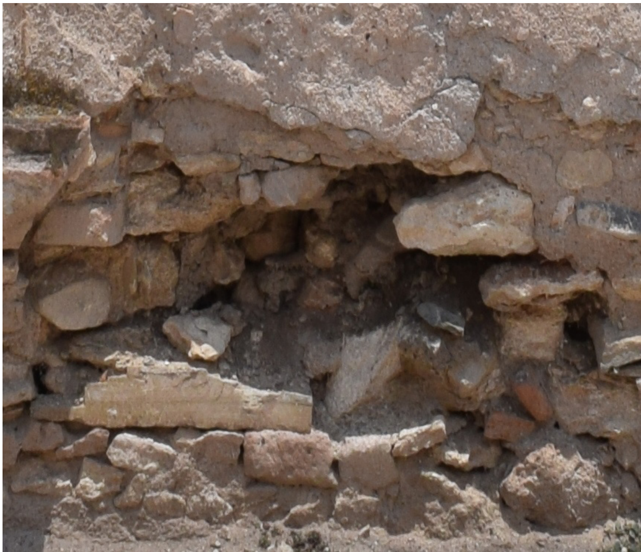
(fotografía 81: Daniel Vargas) (Mineral de Pozos 2016) (Colección personal) estudio Juárez No 6. en Mineral de Pozos. Fachada estado actual deterioro.
