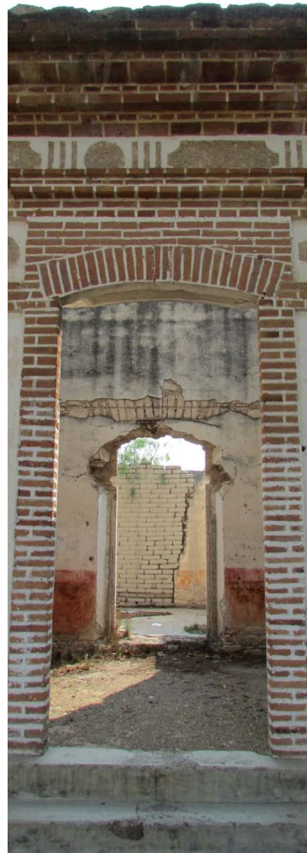
Fig.18 Vano en el edificio 1
