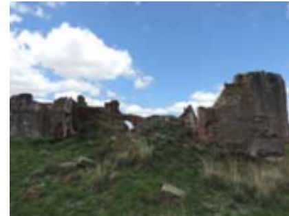
9. VISTA DE CUARTERÍA Muros derrumbados, relictos de aplanados y sin cubierta
