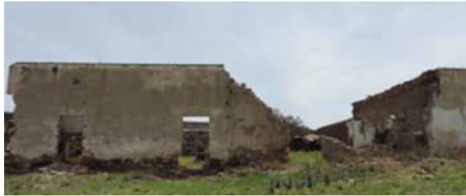
8. VISTA DE CUARTERÍA Muros faltantes, relictos de aplanados y sin cubierta
