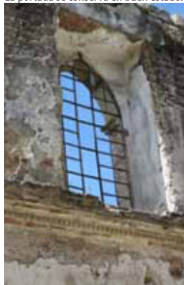
14. VENTANA EN CAPILLA Podemos observar muros de adobe con algunos refuerzos de ladrillo en los remates.
