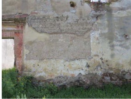
Figura 11. Detalle de rajueado en fachada. Foto: A.R.E, 2013.
