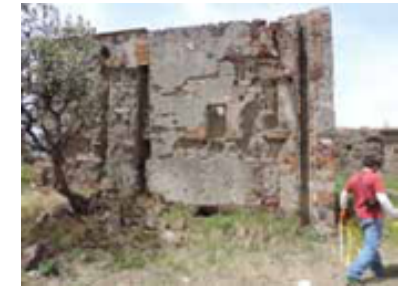
11. VISTA DE CUARTERÍA Esquina del edificio y muros derrumbados
