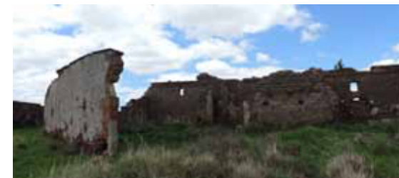
2. VISTA DE LA ESQUINA SUR Esquina incompleta sobre cimientto de piedra y muros de adobe
