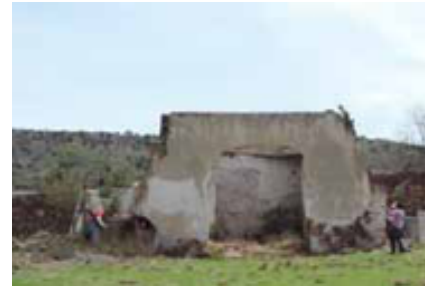
9. VISTA PARCIAL DE FACHADA PRINCIPAL Muros derrumbados, relictos de aplanados y sin cubierta
