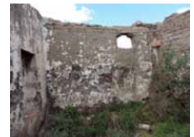
6. VISTA DE CUARTERÍA Muros con vanos y relictos de aplanado
