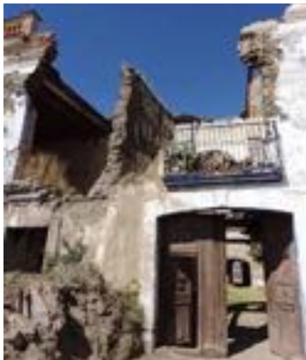
Figura 64. Derrumbe de muros de la fachada principal de la Casa Grande en la Exhacienda Zotoluca. Fotografía: A.R.E, 2014.
