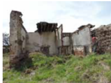
13. VISTA DE LA ESQUINA DEL EDIFICIO Cubiertas deterioradas
