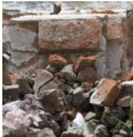
Figura 63. Derrumbe de muros de la fachada principal de la Casa Grande en la Exhacienda Zotoluca. Fotografía: A.R.E, 2014.
