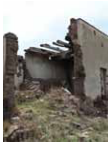
7. VISTA DE CUARTERÍA Muros y cubierta derrumbados.
