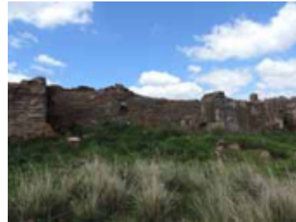
8. VISTA DE CUARTERÍA Muros faltantes, relictos de aplanados y sin cubierta
