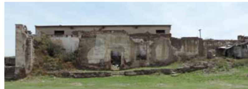
5. VISTA PARCIAL DE FACHADA PRINCIPAL Muros derrumbados con vegetación invasiva
