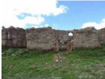
7. VISTA DE CUARTERÍA Muros deteriorados de adobe, sin cubierta
