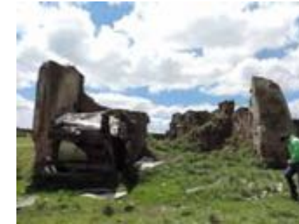
11. VISTA DE CUARTERÍA Esquina del edificio, muros derrumbados y construcciones temporales
