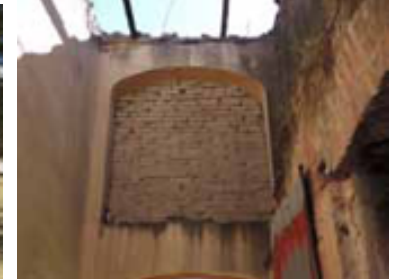
25. VANO TAPIADO Vano clausurado en primer nivel, muros de adobe con aplanado cal-arena
