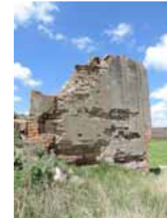
10. VISTA DE CUARTERÍA Esquina del edificio relictos de aplanados y muros derrumbados
