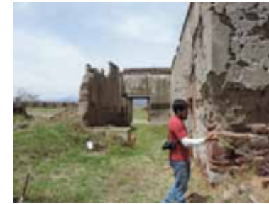
10. VISTA DE CUARTERÍA Esquina del edificio, relictos de aplanados y muros derrumbados
