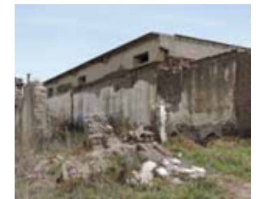
6. VISTA PARCIAL DE FACHADA PRINCIPAL Muros de adobe derrumbados
