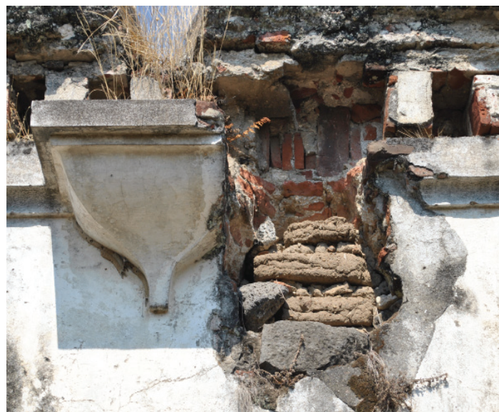
Figura 1.16 Detalle del muro norte del interior de los purgares, donde se observa la cornisa, ménsula, mechinales, tabiques cocidos y adobes que conforman el muro. Archivo fotográfico de Mariana Sainz 2014.
