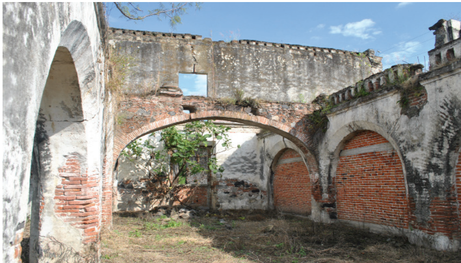
Figura 2.1 Vista del interior de los purgares, se observa la falta de cubierta, orificios grandes en las filas de arquería, manchas negras en muros (microorganismos) y faltante de aplanados.
