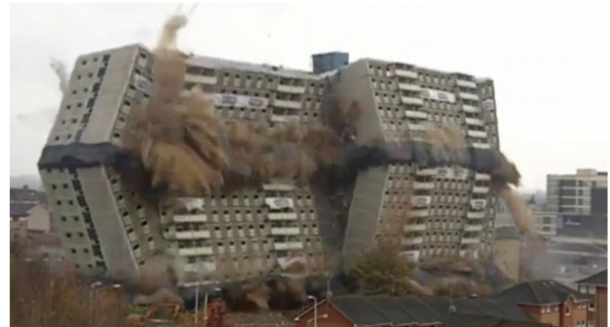
Demolición de bloque de departamentos en Escocia, produjo 12 000 toneladas de escombros. Imagen de antena3.com.
