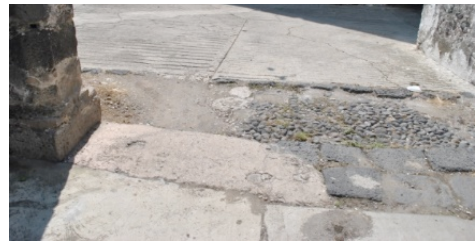
Figura 3.21 Pavimento alrededor de los purgares. Fotografía tomada por el equipo de este trabajo.
