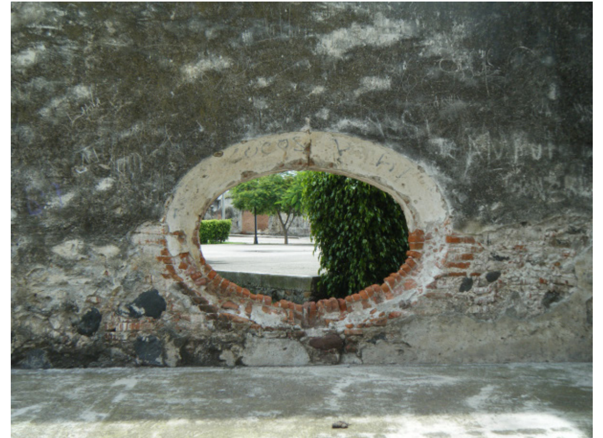
Debido a la composición de los muros, cualquier restitución deberá seguir la lógica del mampuesto mixto. Archivo personal.
