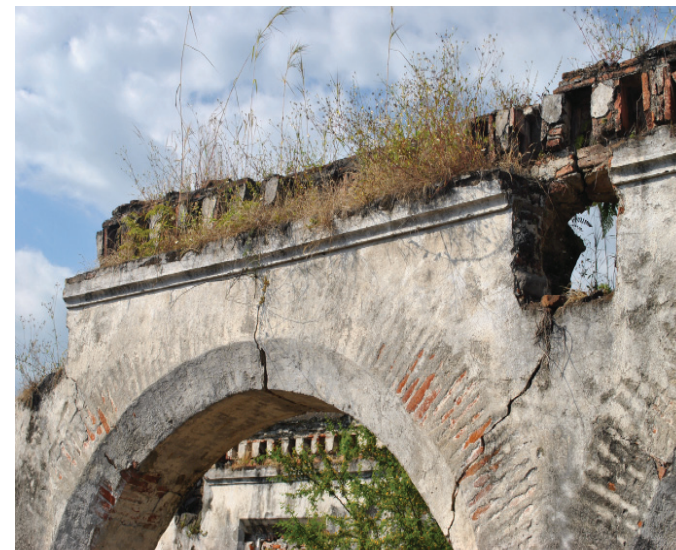
Figura 2.2 Detalle del arco anexo al que colapsó, se observan fisuras (incluso en la clave), por lo que se encuentra en riesgo de colapso. Además se observa el crecimiento de plantas superficiales entre los orificios de los mechinales, y faltante de material en donde posiblemente se encontraba una viga.
