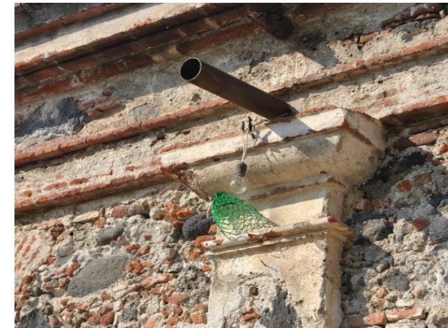
Figura 2.3 Bajante de metal en la fachada sur y debajo de ésta de una instalación eléctrica expuesta. Se observa además detalles de abrasión por la caída de agua.
