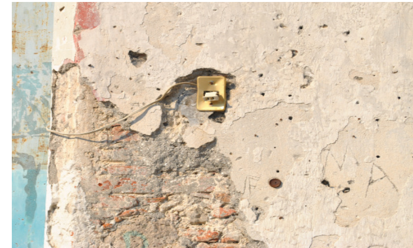
Figura 2.5 Detalle de orificios de distintos tamaños, faltante de aplanado, instalaciones eléctricas expuestas y vandalismo (por abrasión al muro).
