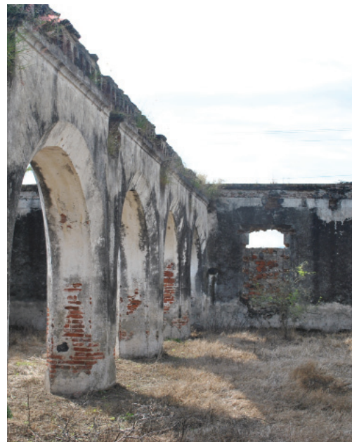
Figura 1.2 Detalle de las filas de arquerías con el muro poniente en el fondo. Archivo fotográfico de Mariana Sainz 2014.
