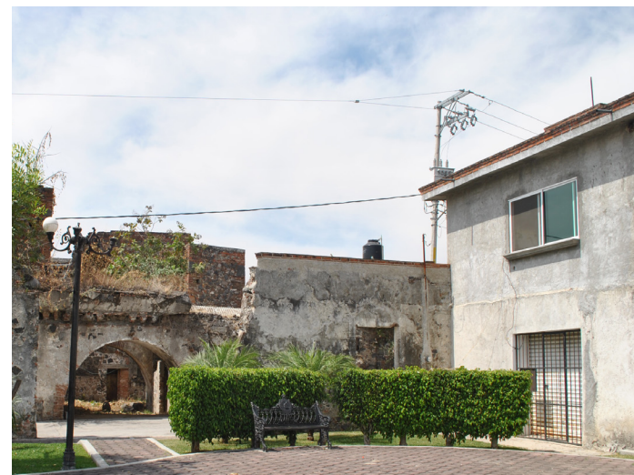
Muro contemporáneo frente a la plaza central, entre la capilla y los purgares. Archivo personal.
