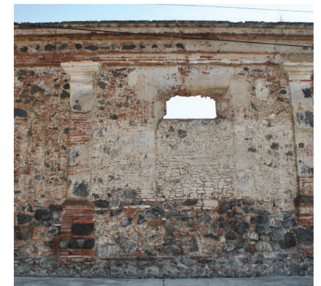
Figura 1.19 Detalle del vano tapiado en el muro poniente del exterior de la casa. Archivo fotográfico de Mariana Sainz 2014.
