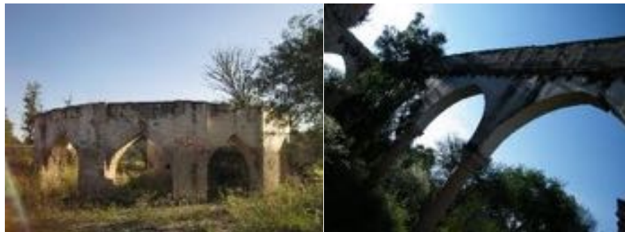
Ilustración 90. Arcos ojivales de la isla al centro del contenedor de agua. Ilustración 91. Arcos que conforman el área porticada del baño turco.
