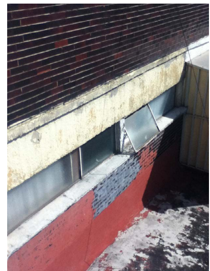
Vista de volado en nivel 8 de la fachada poniente. Se puede apreciar el desgaste en el acabado aparente del block vidriado y la consecuente aplicación de pintura.
