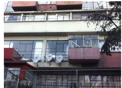
Vista de la fachada oriente. Se puede apreciar la variación de tono en la pintura de los balcones, manchas generadas por escurrimiento de agua en balcones y muros, ampliaciones no reguladas e instalación de antenas de tv que alteran la imagen de la fachada.
