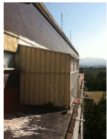
Vista de volado en nivel 8 de la fachada poniente. Se puede apreciar el desgaste en el impermeabilizante de la losa, eflorescencias en traves, crecimiento de fauna invasora y ampliaciones no reguladas.
