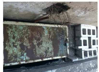
Vista de registro principal de instalaciones en remediación de la fachada poniente.
