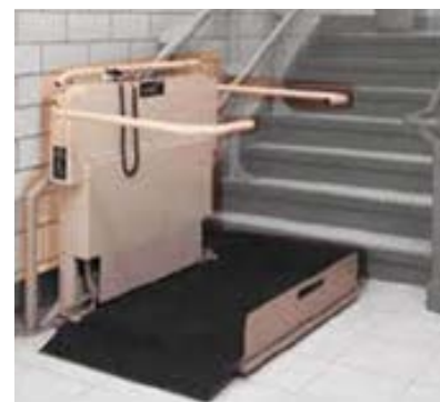
Elevador para silla de ruedas en escaleras.
