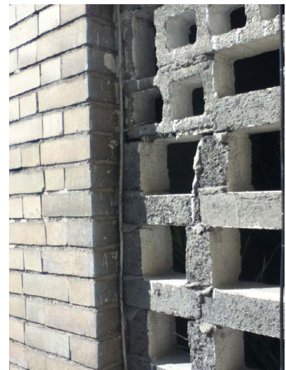
Vista de junta entre muro de celosía y muro de block hueco vidriado en la fachada poniente. Se puede apreciar el desgaste de acabado y la disgregación de material en las piezas de la celosía, así como el desgaste del block vidriado que ha perdido su acabado por factores climáticos.
