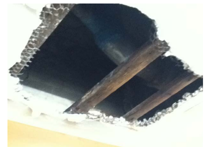
Vista de plafón en cocina y tubería de Fo Fo para instalación sanitaria.
