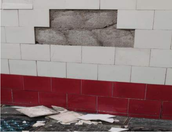
Imagen 58 Desprendimiento en recubrimiento, Fuente fotografía Laura Venancio
