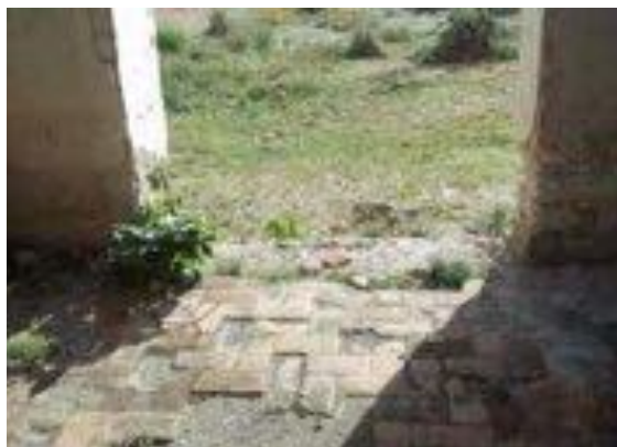
Imagen 4.34 Piso en deterioro
