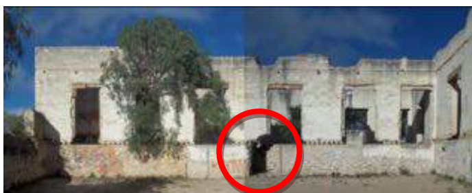
Imagen 4.45 e imagen 4.46, Zonas detectadas con riesgo de colapso
