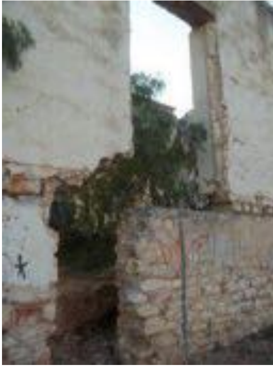
Imagen 4.29 Muro en peligro de colapso
