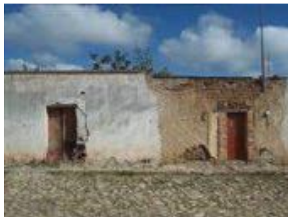
Imagen 3.61 Fachadas antes de su intervención
