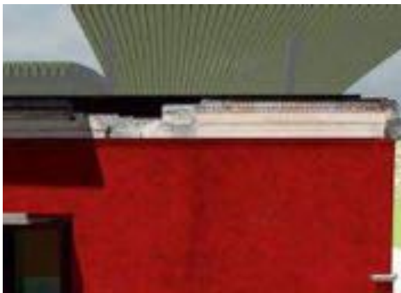
Imagen 4.55 Cantería deteriorada como elemento que evoca temporalidad y autenticidad.
