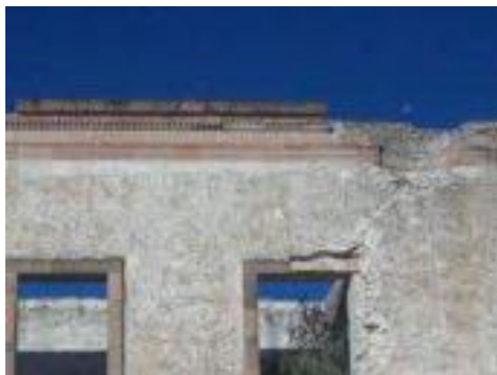
Imagen 4.27 Grieta en la fachada oriente
