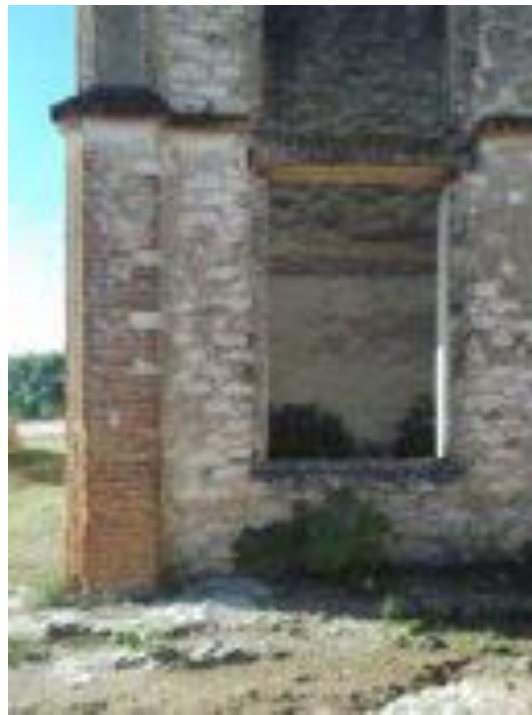
Imagen 4.31 Se carece en su totalidad de puertas y ventanas
