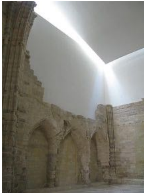
Figura 33. En la Capilla de los Condes de Fuensaldaña se resalta el perfil de la ruina con luz rasante. Fuente: Ángel Marcos
