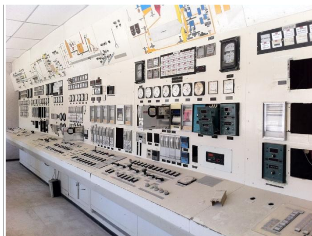
Fig.3: Consola de control en el edificio A Fotografías: Omar Peña Coya
