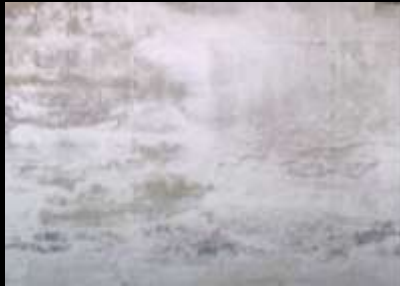
Manchas por retención de humedad. Esta humedad esta causando la escarificación en el concreto debido a la oxidación que presenta el acero.
