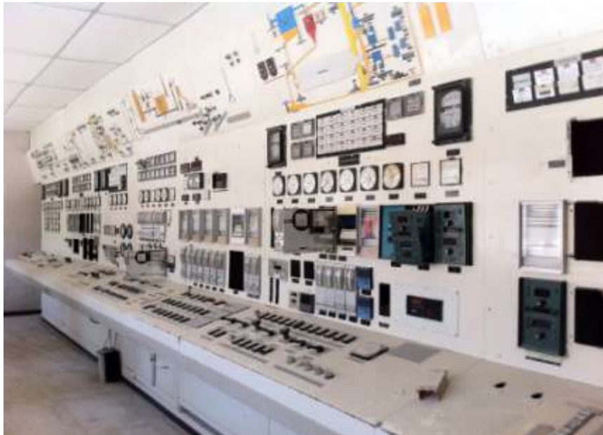
Fig.3: Consola de control en el edificio de deposito de clinker. Fotografías: Omar Peña Coya
