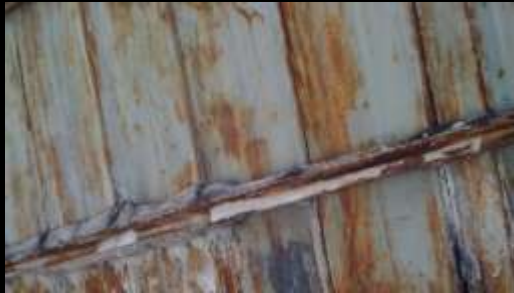
Se observa en los elementos metálicos que conforman la estructura al quedar expuesto al medio ambiente sin un recubrimiento, esto por la falta de mantenimiento en el edificio por más de 20 años..
