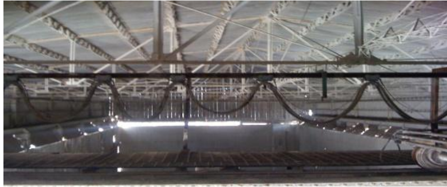
Fig.72. Armadura a dos aguas, con secciones triangulares de acero remachadas. Se encuentra en buen estado estructural, la recomendación es sólo reemplazar algunos remaches y liberarla de la acumulación de cal.
