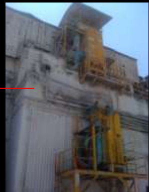
Agregado de elementos ajenos a la estructura (maquinaria), provoca oxidación, corrosión, grietas, fisuras etc de bajo impacto
