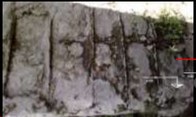
Escarificación y desprendimiento del concreto en su soporte de acero Se observa en la parte superficial de los muros de concreto debido a la oxidación del acero de refuerzo, esta expansión se debe al exceso de humedad.
