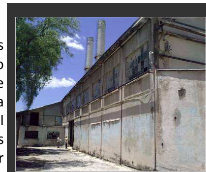
Fig. 26.- Imagen de la fachada lateral donde se observan los deterioros causados por la exposición a la intemperie sin ningún tipo de mantenimiento preventivo.
