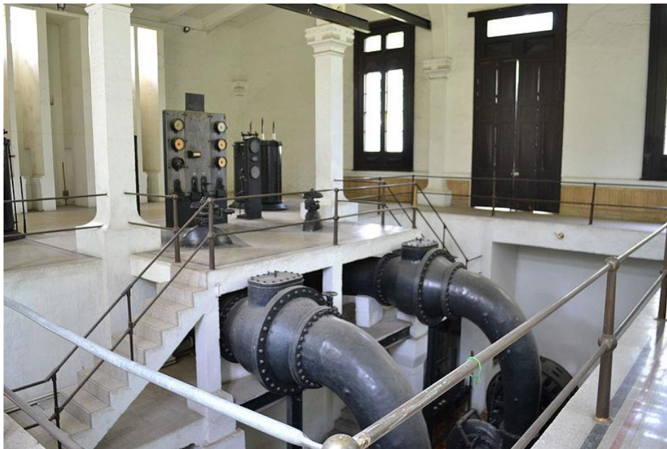
6 Vista interior de la casa de bombas. Centro de Educación Ambiental Acuexcómatl: San Luis Tlaxialtemalco, Delegación Xochimilco en la Ciudad de México
