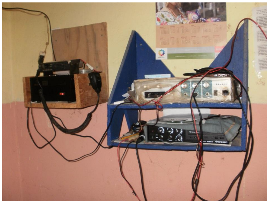
Fig. 24 – Unidad de comunicación por radio en la comisaría de El Llano. En los bordes de la tabla azul que sostiene la consola se pueden observar las capas de polvo acumuladas, en este caso, a pesar de la protección de un periódico, trapo y plástico. Fotografía tomada el 20 de julio de 2010.
