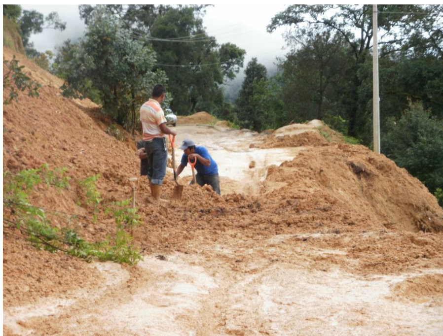
Fig. 2 48 – Deslave del cerro sobre el camino que comunica a la ciudad de Tlapa de Comonfort con el municipio de Acatepec. Durante la temporada de lluvias los caminos se derrumban a diario y cada día son arreglados por los pobladores con palas y machetes. Fotografía tomada el 25 de agosto de 2010.
