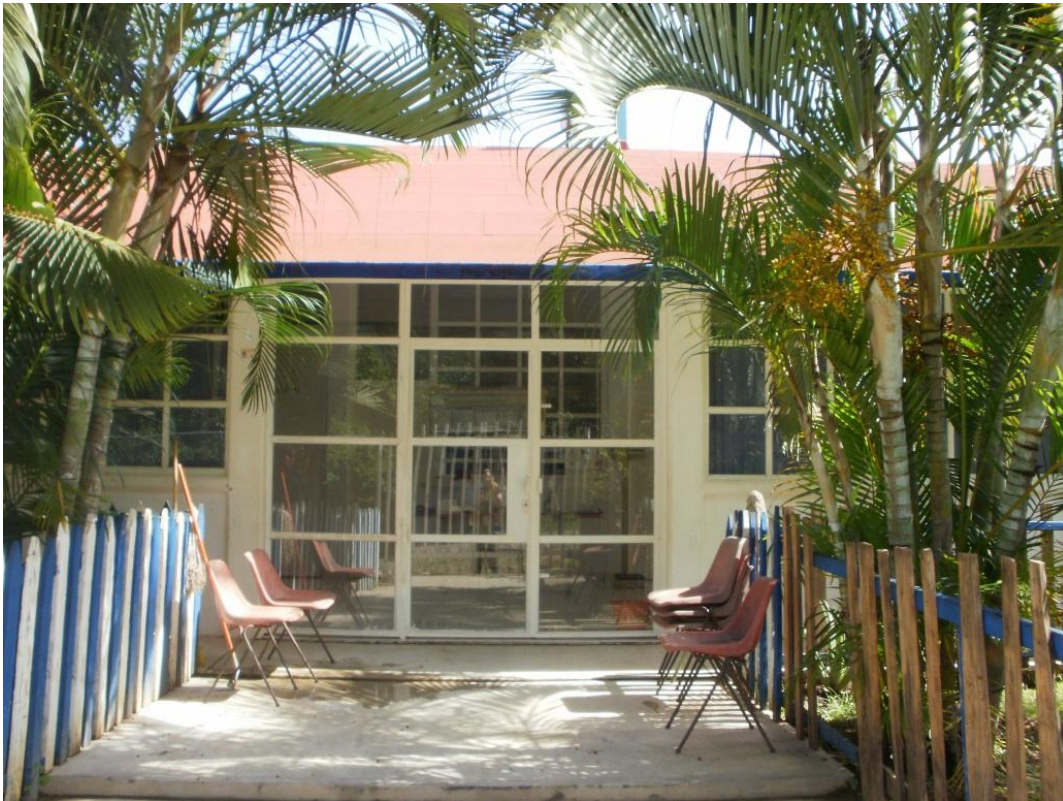
Fig. 17 – Clínica de la localidad de Caxitepec. En ésta el médico nos mostró y nos contó que, a pesar de que la clínica tenía poco tiempo de haber sido construida, ya se habían agrietado algunas paredes y el piso debido a la humedad, así mismo nos habló sobre la falta de equipo necesario para estudios médicos apropiados. Fotografía tomada el 28 de agosto de 2010.
