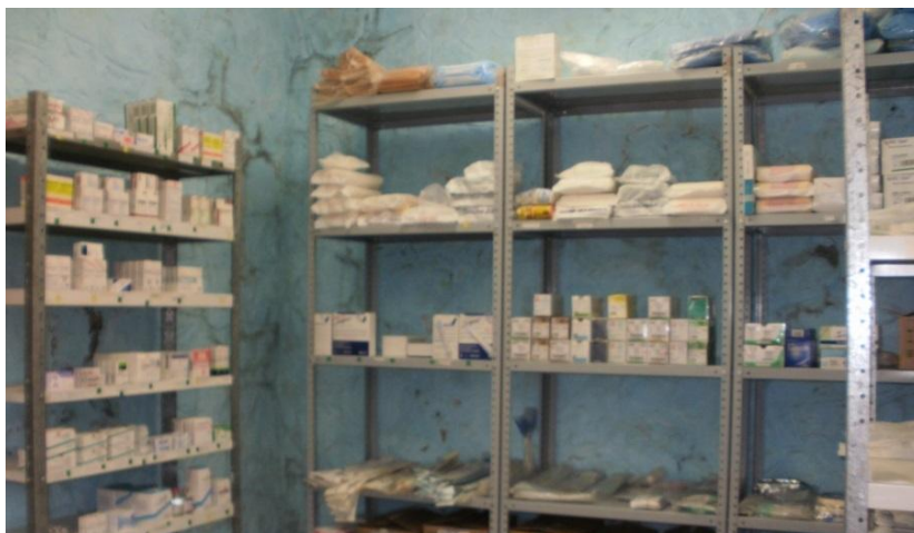
Fig. 22 – Farmacia del hospital de Acatepec en la cabecera municipal. Como se puede observar en la imagen las paredes están cuarteadas debido a la humedad en la región. Fotografía tomada el 11 de julio de 2010.
