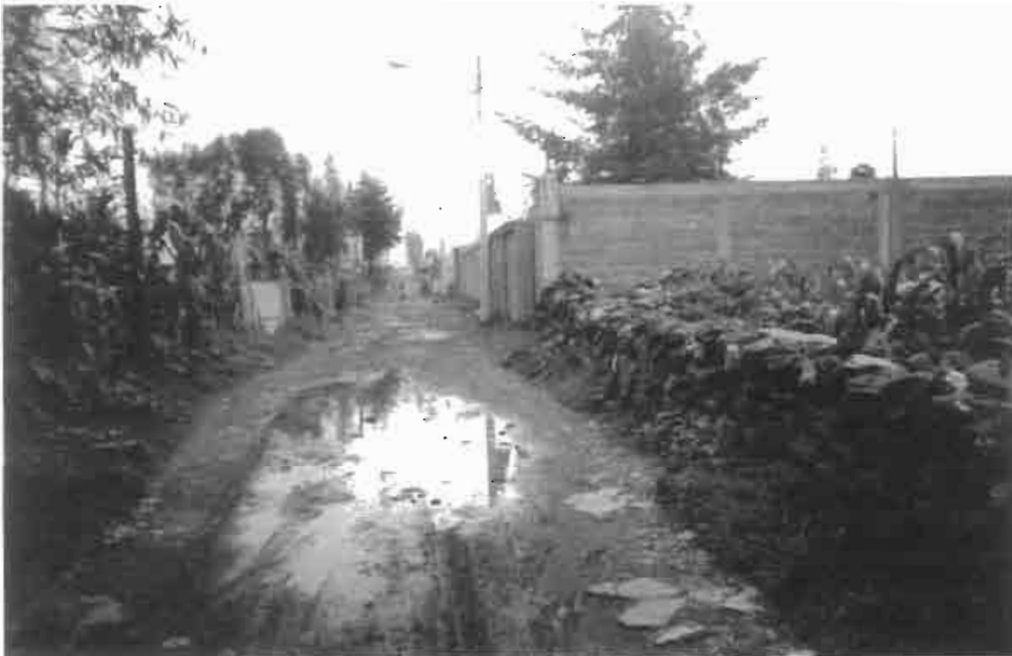
Falta de Pavimentación
