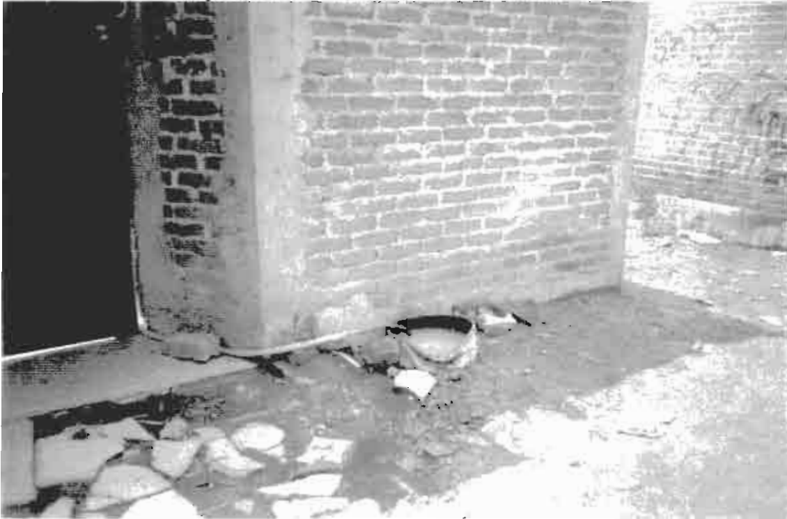
Falta de Toma de Agua Potable
