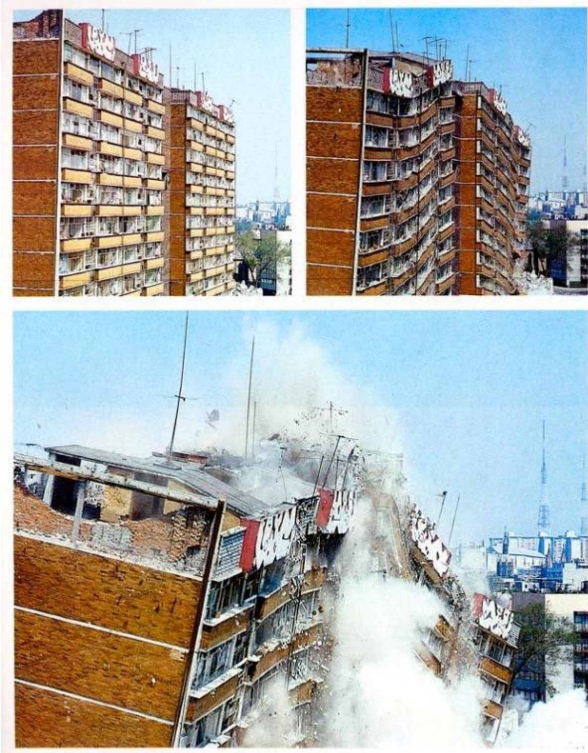
Figuras 30, 31 y 32. Multifamiliar Juárez, demolición de los edificios dañados. 1985. Fuente: U.S. Geological Survey Library-USGS. http://library.usgs.gov/ ; fotógrafo Celebei M.
