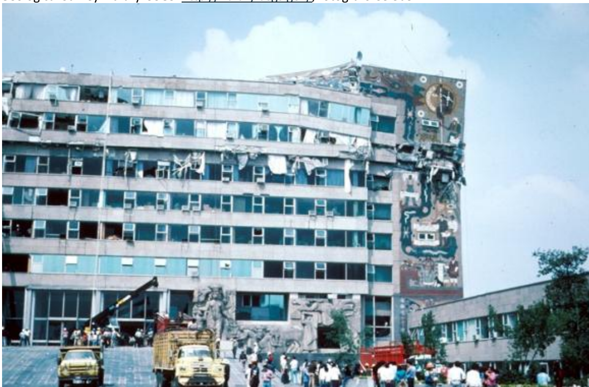
Figura 29. Secretaría de Comunicaciones y Obras Públicas, colapso de niveles superiores. 1985. Fuente: U.S. Geological Survey Library-USGS. http://library.usgs.gov/ ; fotógrafo Celebei M.
