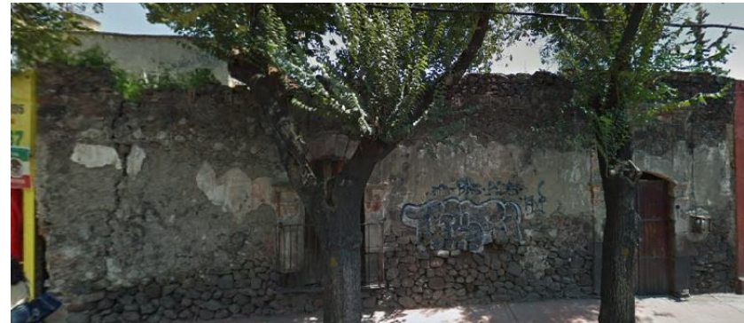
Fotografía núm. 11. Inmueble ubicado en el barrio de Xaltocan en estado ruinoso; algunos inmuebles se dejan a su suerte y en un avanzado estado de deterioro, no obstante que los propietarios los emplean como pensiones de autos o como bodegas de puestos ambulantes; D.R.L.T., 2014.
