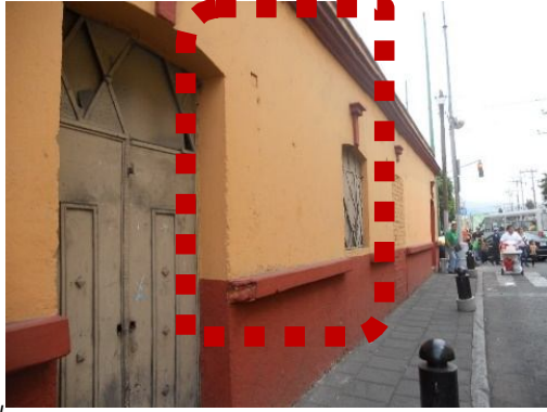
Fotografía núm. 4. Se aprecia un inmueble catalogado ubicado en el centro histórico de Xochimilco en estado de abandono y con deterioro parcial, vanos tapiados y pérdida de entablamentos; D.R.L.T., 2014.
