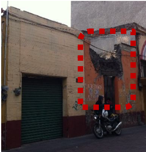
Fotografía núm. 5. Inmueble catalogado ubicado en el centro histórico de Xochimilco con daño estructural o destrucción; D.R.L.T., 2014.
