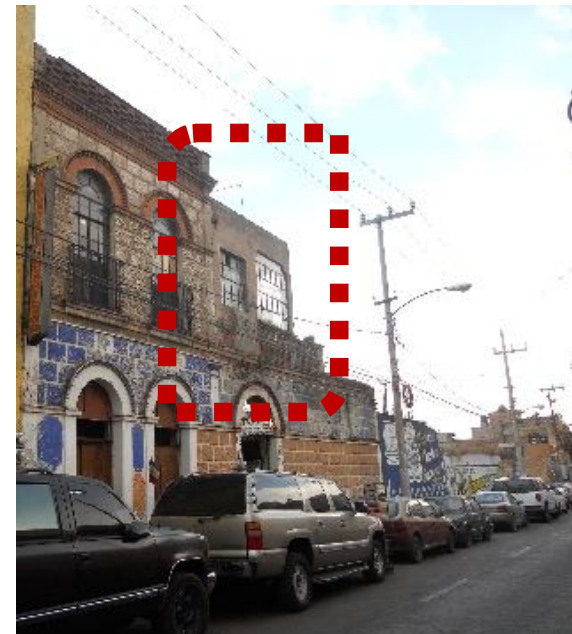
Fotografía núm. 3. Se observa un inmueble catalogado ubicado en el centro histórico de Xochimilco que presenta la superposición de una construcción de reciente manufactura con niveles superiores a los establecidos en la carta de uso de suelo; D.R.L.T., 2014.
