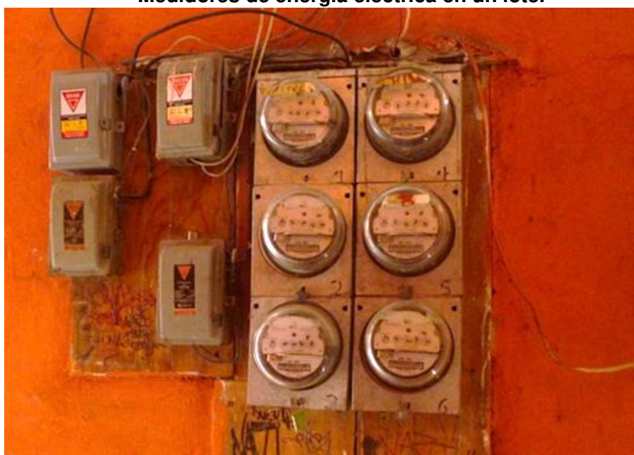
Imagen 16. Pedregal de Santo Domingo. Medidores de energía eléctrica en un lote.
