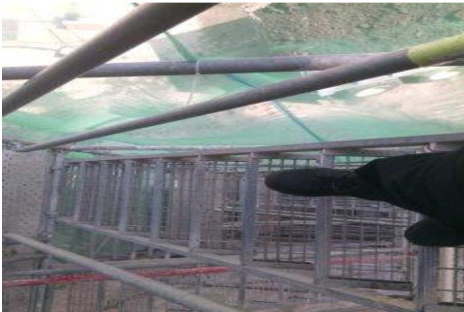
Figura 9. Escaleras metálicas para el descenso a la obra.
