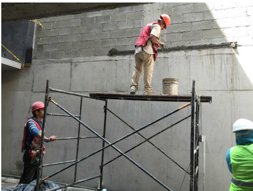
Imagen 3. Ahogado de tubería en muro
