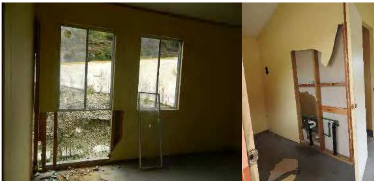
Foto 194, Foto 195. Vivienda destruida y desvalijada en la Ciudad Rural Sustentable “Santiago El Pinar”
