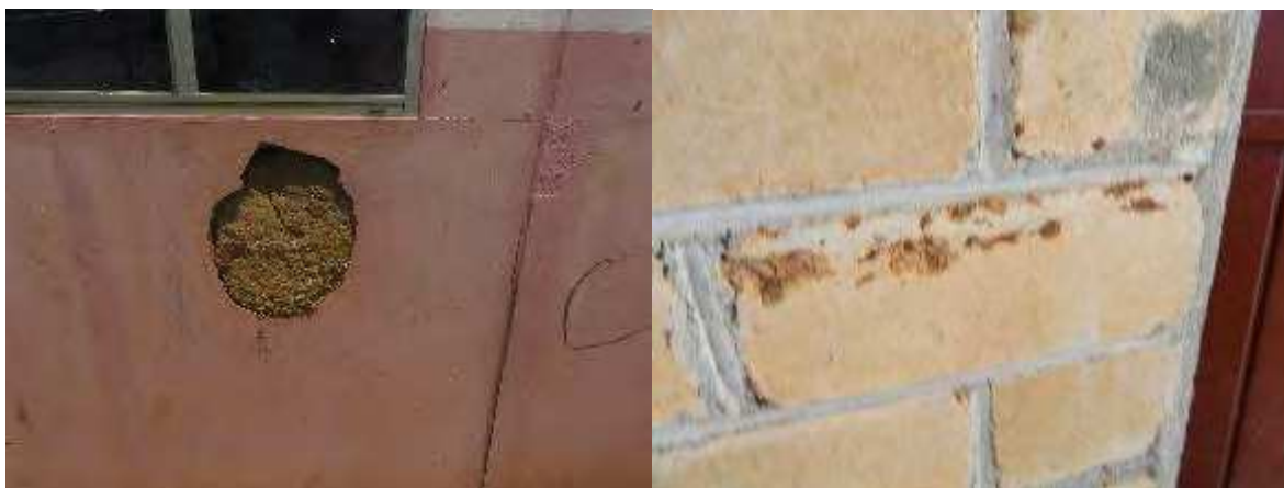
Foto 252. Pared en una vivienda de la Ciudad Rural Sustentable “Santiago El Pinar”
