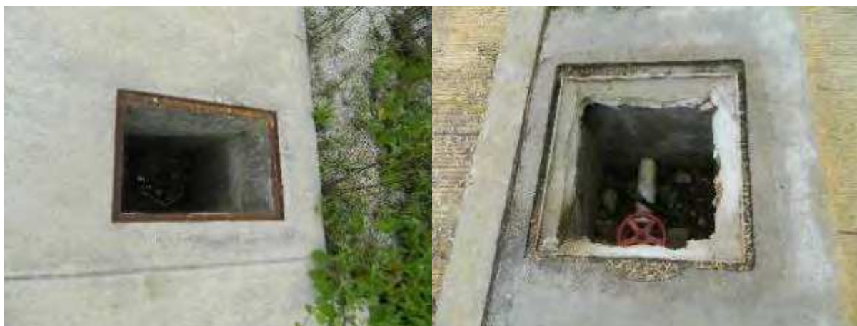
Foto 94, Foto 95. Instalaciones de agua públicas en mal estado
