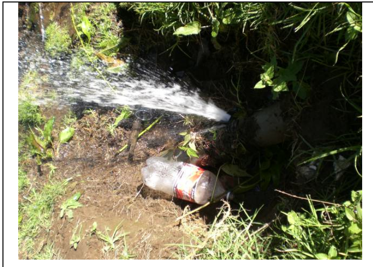
Gráfico 5. Fuga de agua entre las conexiones de mangueras
