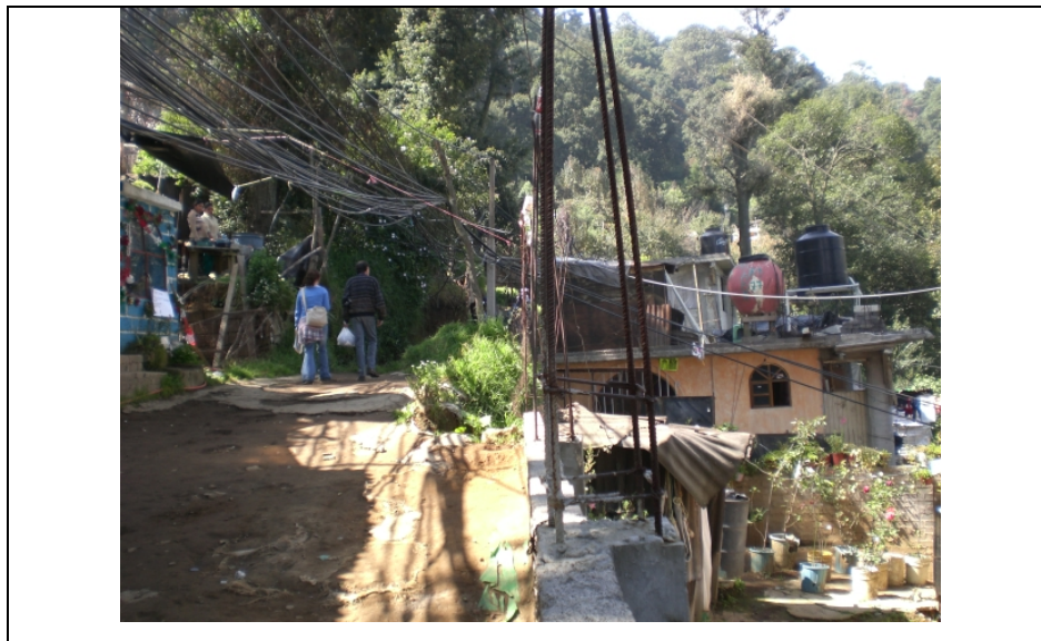
Gráfico 8. Cableado aéreo en el asentamiento denominado Tierra Colorada
